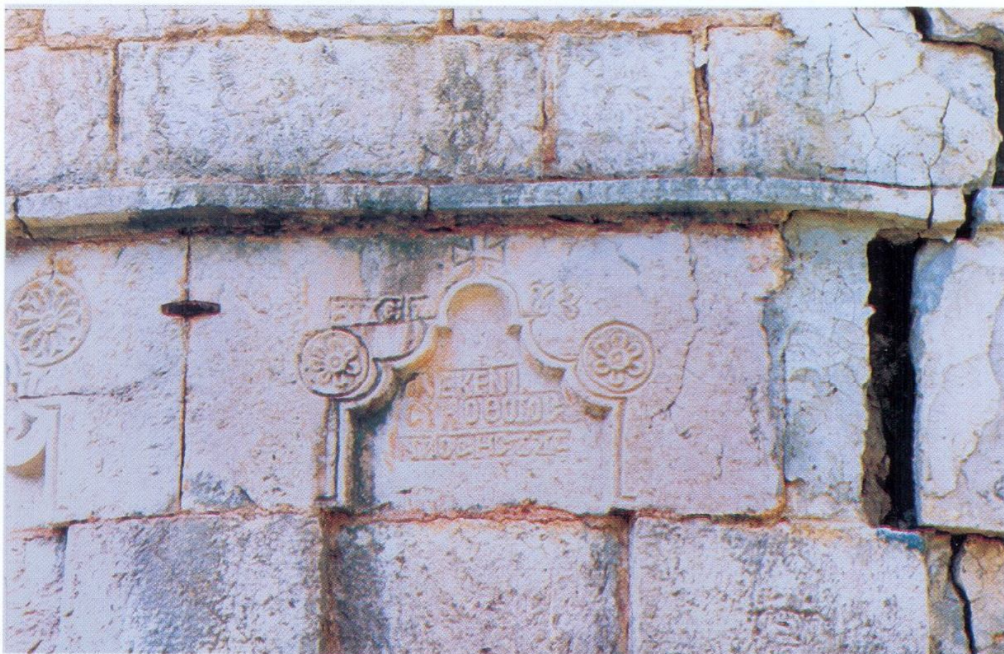
Εικόνα 9α. Ρωγμές στην αψίδα του καθολικού της μονής που προκλήθηκαν από τον σεισμό του 1967
