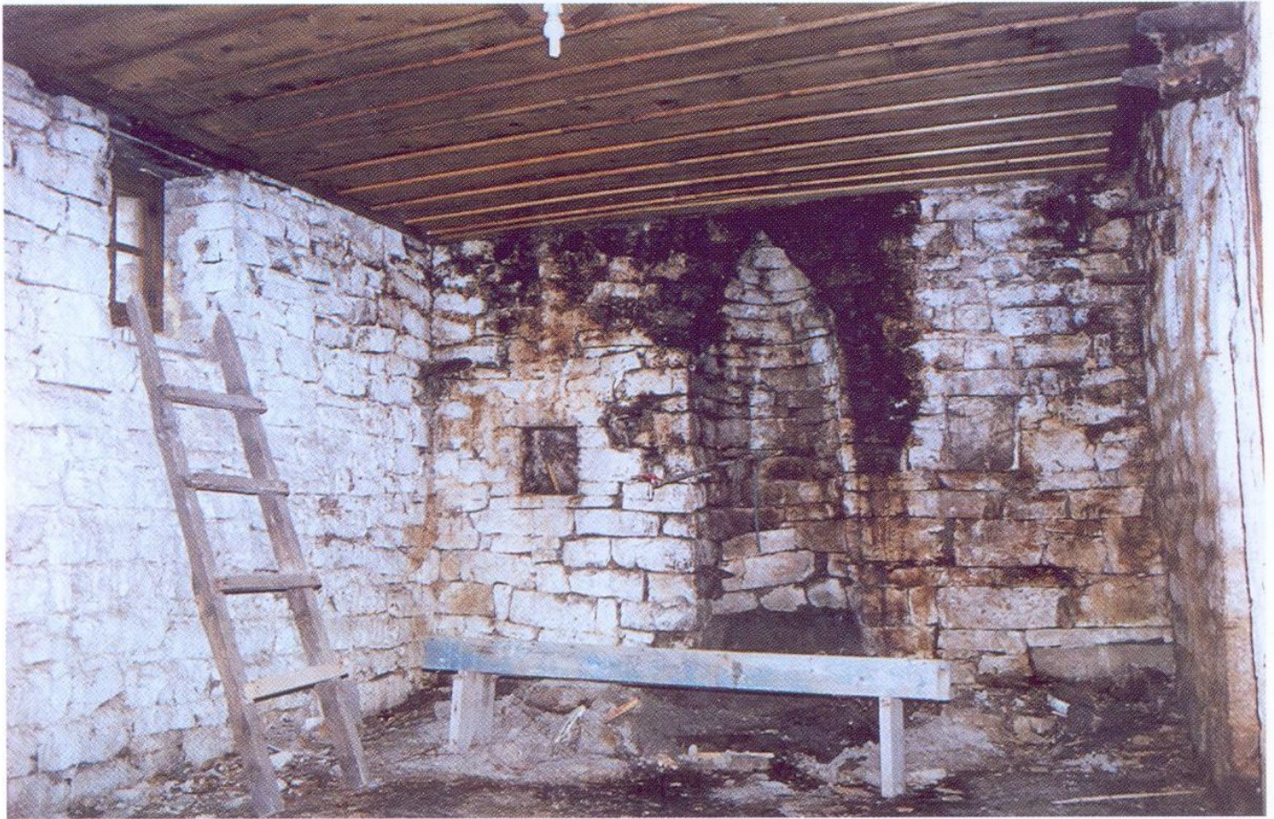
Εικόνα 7α. Ένας από τους χώρους των παλαιών κελλίων της μονής, ο οποίος είχε μετατραπεί σε τυροκομείο
