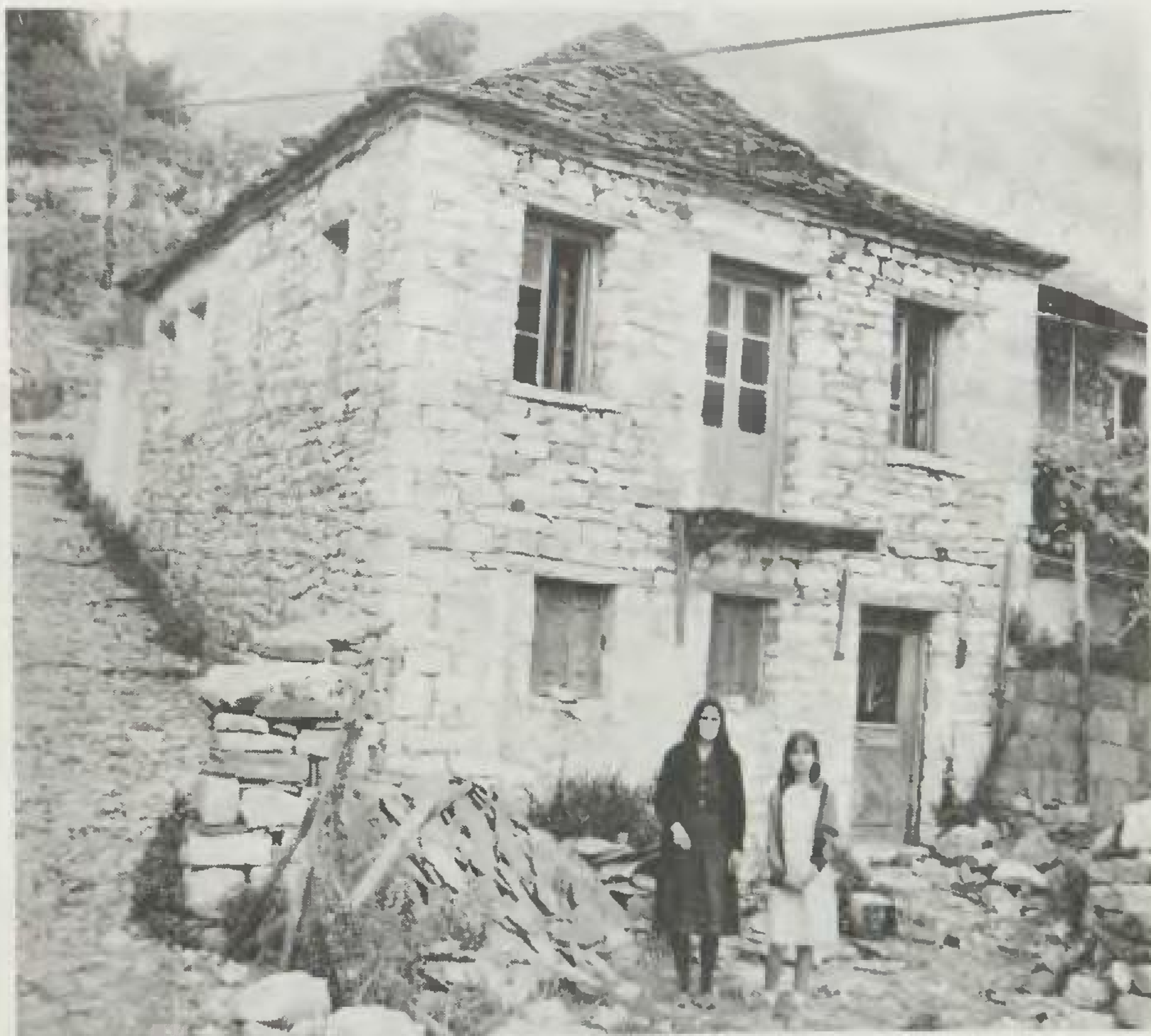
243. Η εγκατάλειψη συνετέλεσε να μείνει αναλλοίωτο το σύνολο: Κτίσμα ολοπέτρινο με πλακόστρωτη στέγη και διπλά γριπίδια, μπαλκόνι και πλακώματα ξύλινα, στο κατώι παλιά μικρά παράθυρα και χωρίς τζάμια (16-8-1985).
