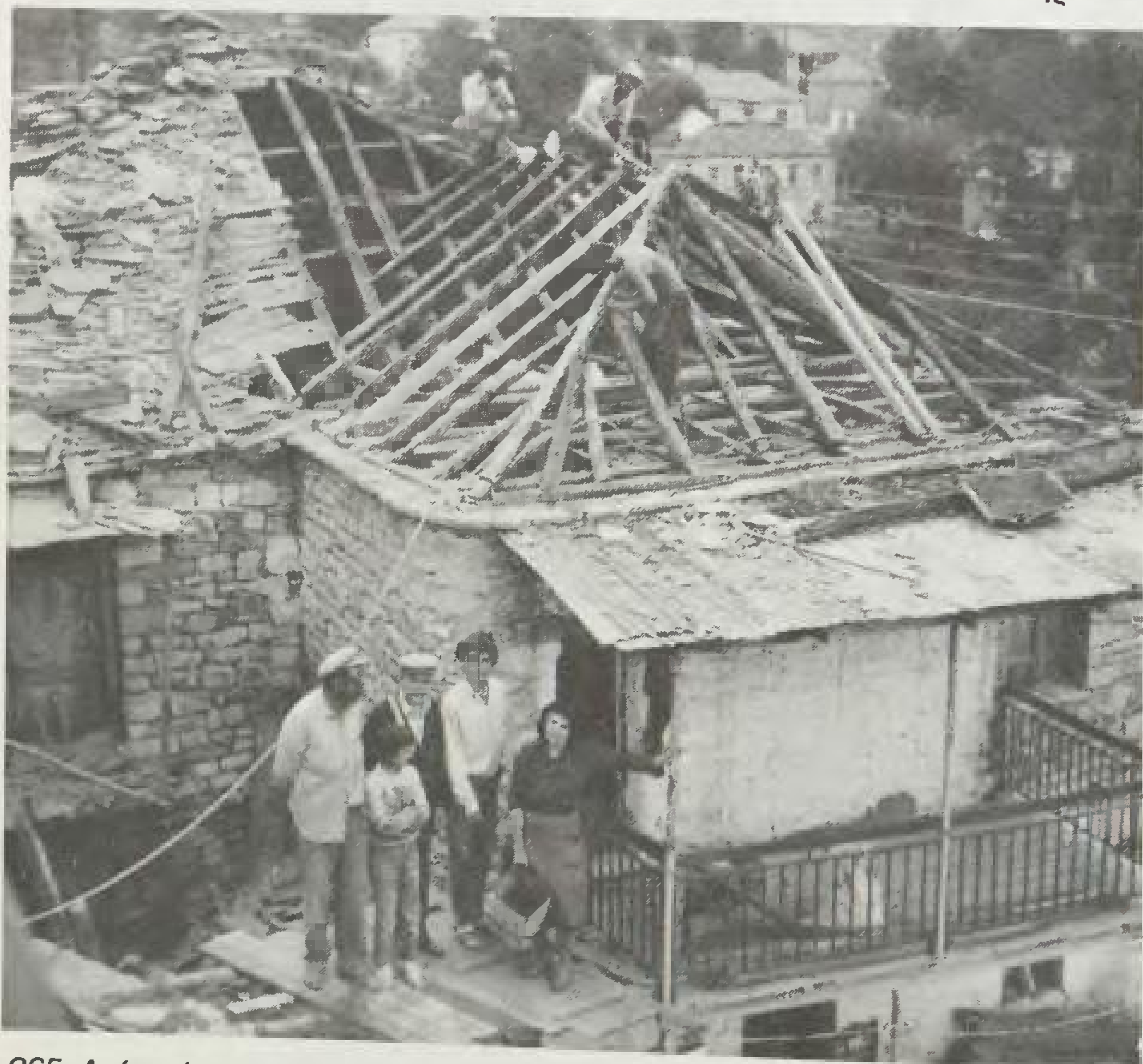
265. Ακόμα ένα παραδοσιακό σπίτι καταστρέφεται (η πέτρινη σκεπή αντικαθίσταται με κεραμίδια, 18-7-1986). Διακρίνονται λεπτομέρειες της σκεπής.
